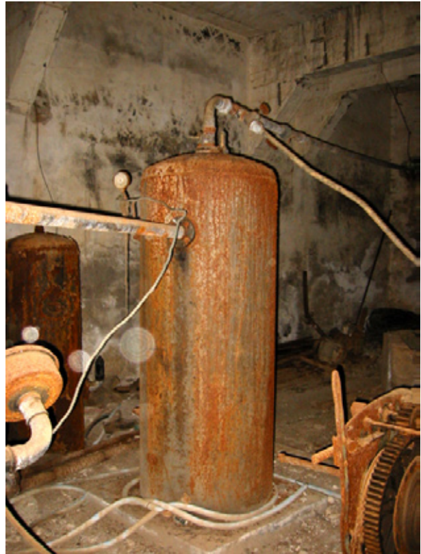
Depósito de un pozo para acumulación de aire comprimido (La Lechucilla). Vega de San Mateo (Gran Canaria) 2003. Colección privada.
