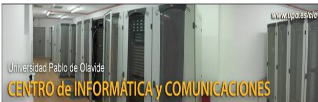
Figura: Centro de Proceso de Datos de la UPO.
