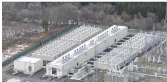
Fig. 4. BESS de la compañía eléctrica Tohoku
