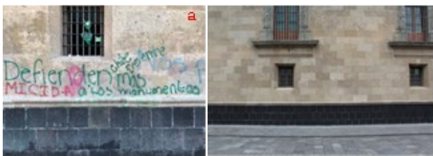
Fig. 2. Detalle de fachada de Palacio Nacional con graffitis. Fig.3. Vista de la fachada después de los procesos de restauración [3]
