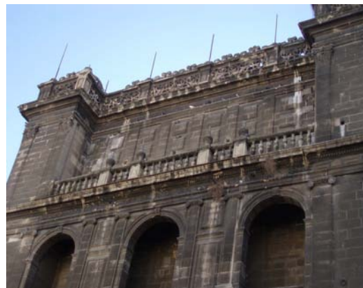
Figura 2. Iglesia del Sagrario, Fachada a la Calle Alemanes, fotografía tomada en 2007, antes de su última restauración. La imagen muestra el deterioro ocasionado por contaminantes ácidos, formándose una zona negra llamada "costra negra".
