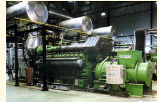
Sistema de Cogeneración
