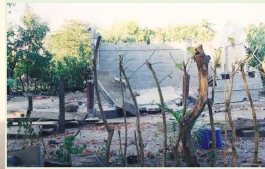
Foto II.1.1. Vivienda colapsada durante el terremoto del 13 de Enero de 2001 en el valle del Río Lempa. El Salvador.
