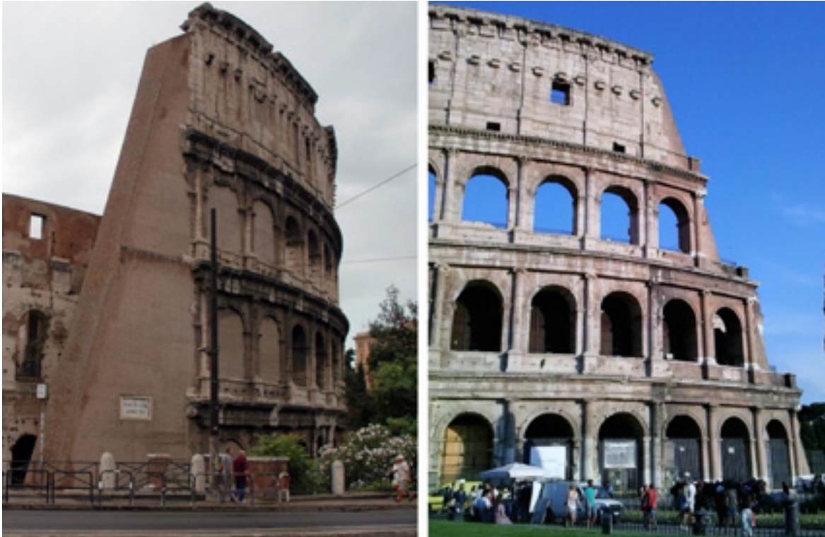
[7]. Contrafuertes realizados en el Coliseo por Raffaele Stern y Giuseppe Valadier en 1807 y 1826 (fots. M. a del Valle Gómez de Terreros, 2014).
