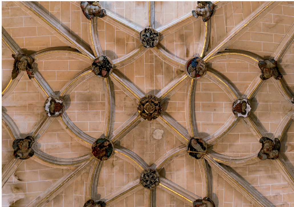
Fig. 8. Claves de la bóveda de la escalera de Soto en el convento de San Esteban de Salamanca, 1553-1556. © Fotografía: Vicente Sierra Puparelli.
