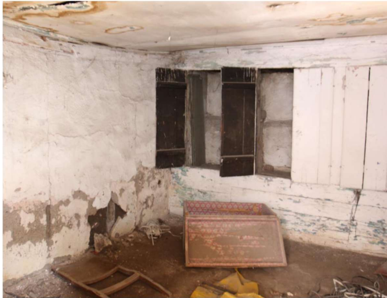
Fig. 30: Interior de una casa abandonada. Subaşı 2022.
