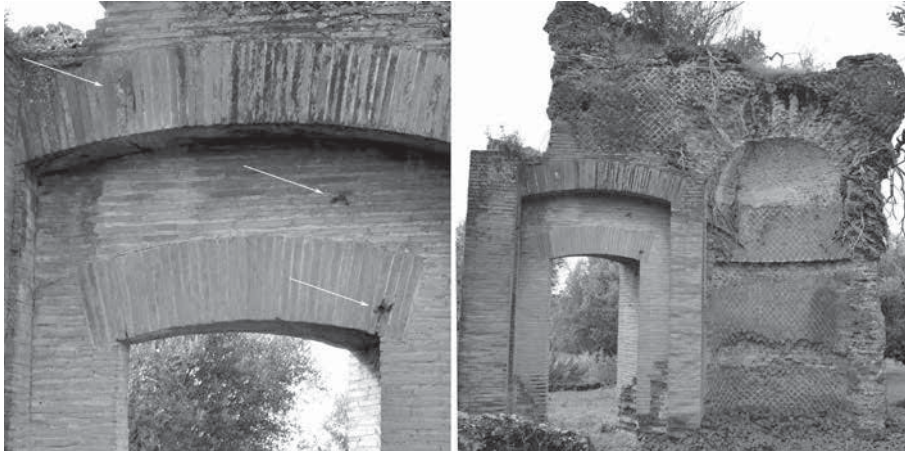
Figura 16. Villa Adriana, Accademia: danneggiamenti da esplosione su un muro del cd. Atrio Mistilineo (foto autore)
