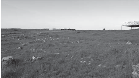
Figura 8. Estado de conservación de las estructuras. Foto de la autora.
