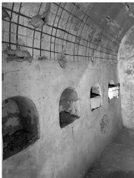
Figura 3. Vista de la pared oeste ( loculi 1-4).
